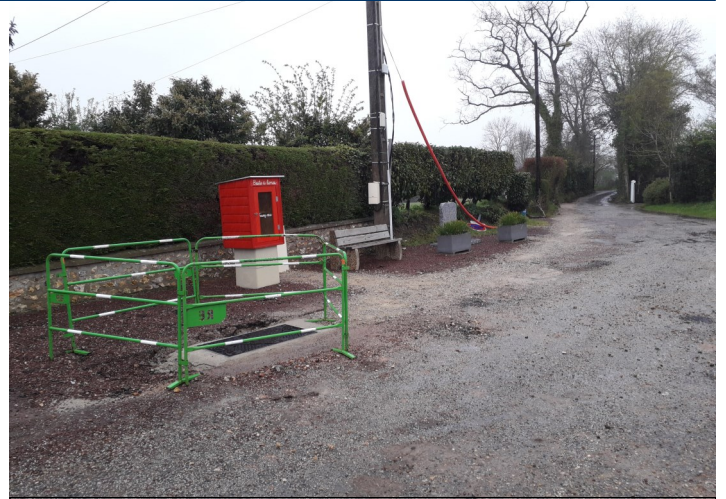
Travaux d'enfouissement de réseaux place du 19 mars. Travaux cofinancés par la commune et le SIEGE 27 (Syndicat Intercommunal de l'Electricité et du Gaz de l'Eure)
