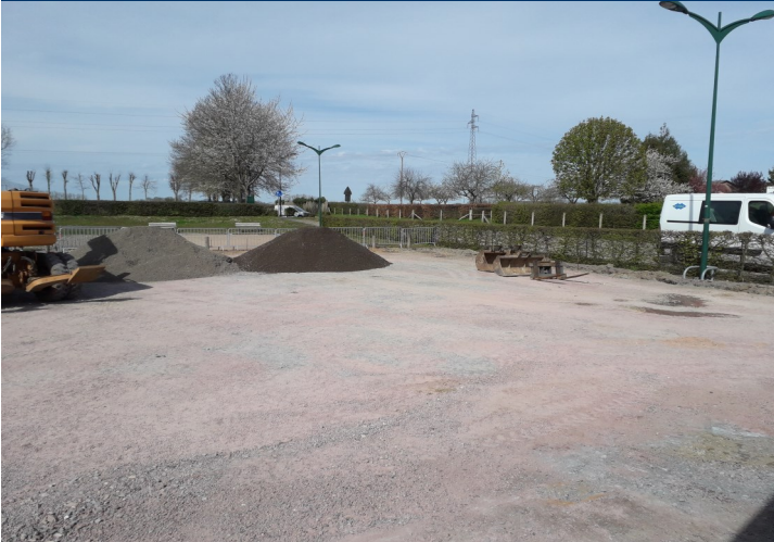
Pose d'un enrobé sur le parking de l'accueil éducatif. Travaux cofinancés par la commune et la Communauté de Communes Pont-Audemer Val de Risle.
